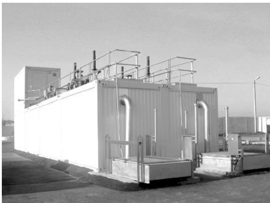
Рисунок 4 – Комплексные локальные сооружения очистки «Адмирал».
